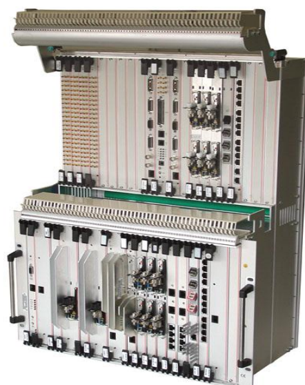
Рисунок В.5 - Узел оборудования Alcatel OPTINEX 1660 SM
